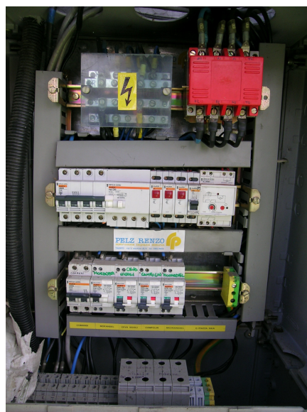
Fig. 11 Particolare quadro elettrico generale I.P. a Daiano (Q05)
