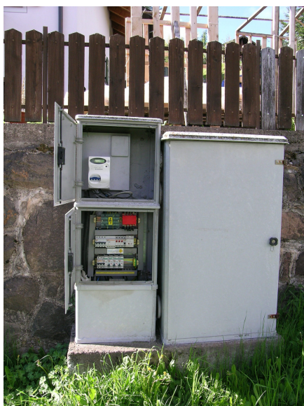
Fig. 10 Quadro elettrico generale I.P. a Daiano (Q05)
