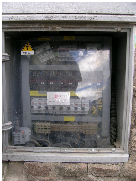
Fig. 10 Quadro elettrico generale I.P. a Daiano (Q03)
