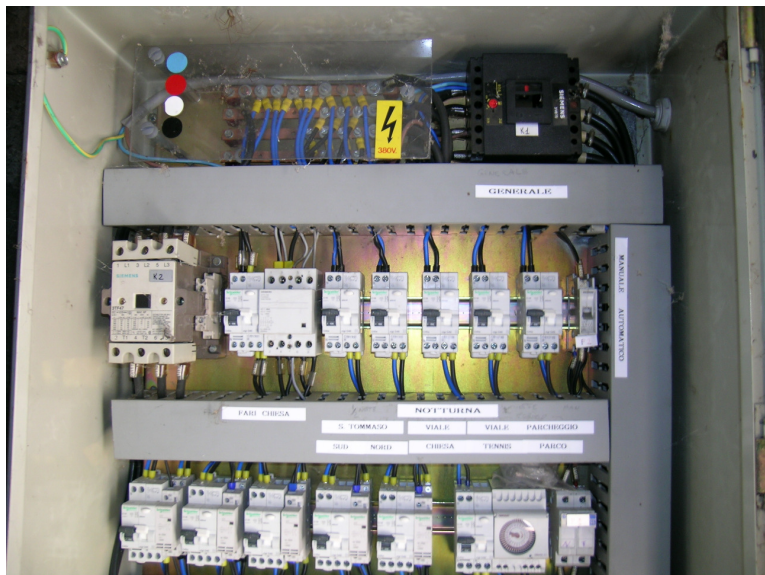
Fig. 7 Particolare quadro elettrico generale I.P. a Daiano (Q01)
