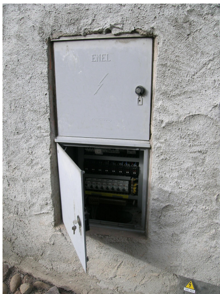
Fig. 10 Quadro elettrico generale I.P. a Daiano (Q06)
