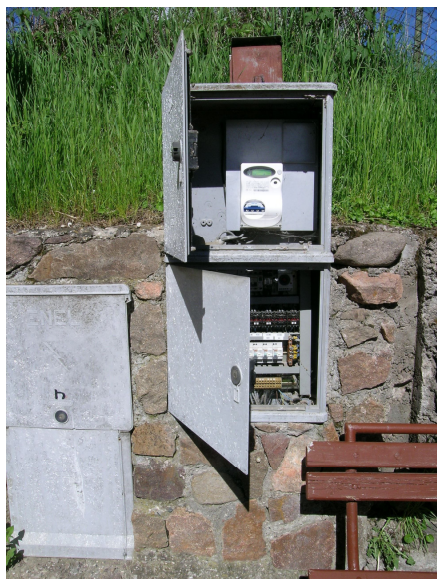
Fig. 8 Quadro elettrico generale I.P. a Daiano (Q04)
