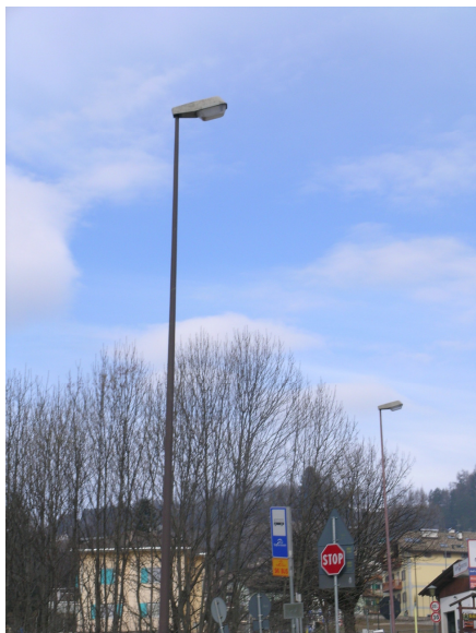
Fig. 12 Armatura stradale 125W HQL (S.S.620)
