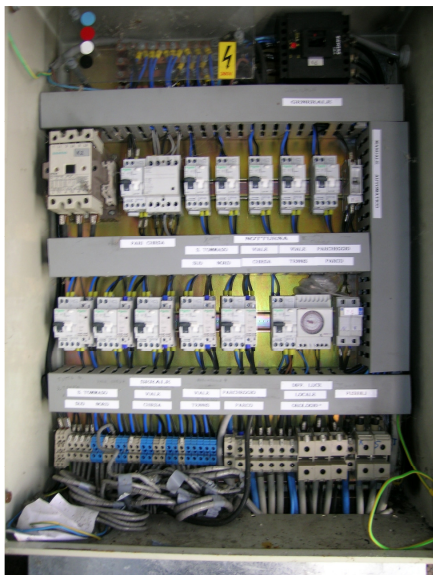
Fig. 6 Quadro elettrico generale I.P. a Daiano (Q01)
